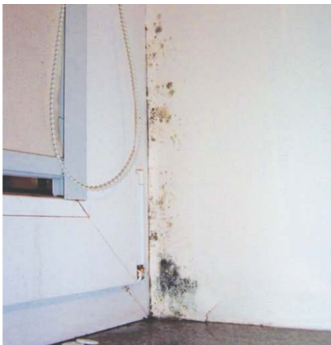
Fot.1 Pleśń w strefach przyokiennych będąca efektem wychłodzonej przegrody i zwykle mało wydajnej wentylacji pomieszczenia
